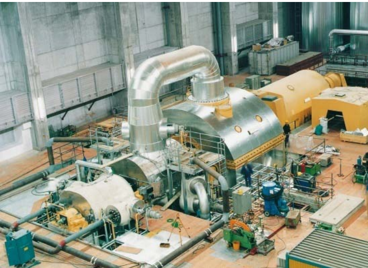
Siemens SST-6000 im Kraftwerk Altbach (BW)
